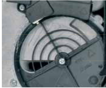
风门挡板部分打开
