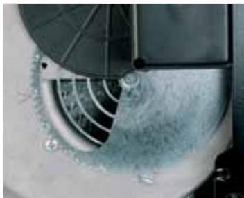
风门挡板部分打开
